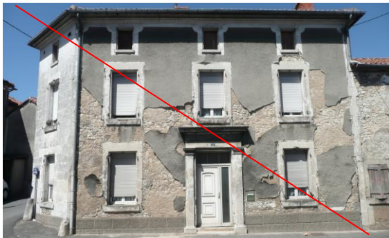
Contre-exemple : remplacement des menuiseries bois par du PVC, retrait des volets en bois...Enduit est abimé en proie aux intempéries et source importante de déperdition thermique.
