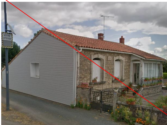
Contre-exemple : isolation par l'extérieur (bardage PVC) sur un pignon (avec débord sur l'emprise publique) – mise à nu du moellon de la façade destinée à être enduite.
