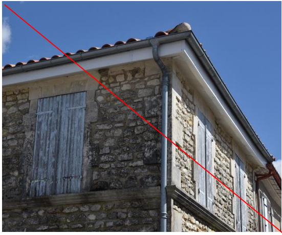
Contre-exemple : Isolation par l'extérieur sur chevron - la toiture a été réhaussée pour l'isolation, la partie extérieure/débordante a été traitée par un caisson/linteau en PVC . Les éléments de détails d'origine sont masqués, la façade dénaturée.
